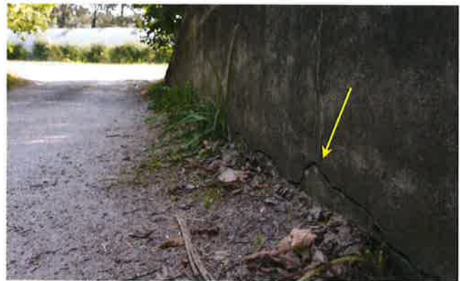
Fissures entre les poutres et le tablier
