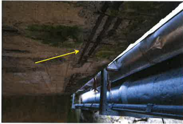
Armatures corrodées – Sous le pont, en amont
